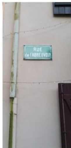
Photo 3 : Descente d'eau pluviale cassée
